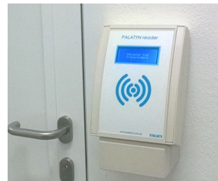
Lecteurs de contrôle d'accès
