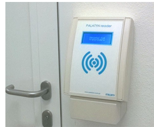
Lecteurs de contrôle d'accès
