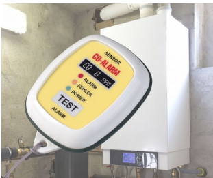
Appareil d'alarme de gaz CO
