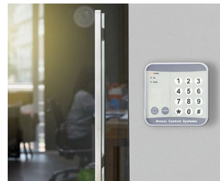
Systèmes de contrôle d'accès
