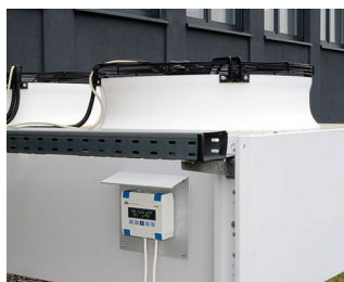
Commande de chauffage/climatisation/ventilation
