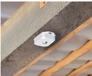
Bewegungsmelder mit Sensor zur automatischen Steuerung
